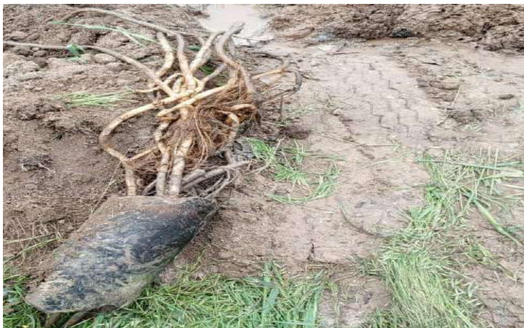
Рис.1.1. Состояние дренажного трубопровода (корни растений).
